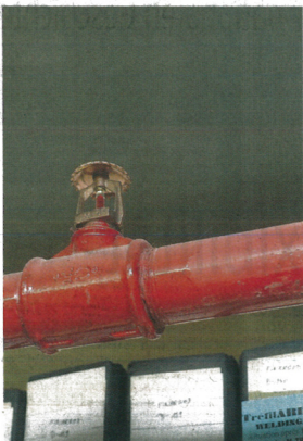
Sprinkleranlagen über historischen Dokumenten – das gehört im Nationalarchiv zur Normalität
