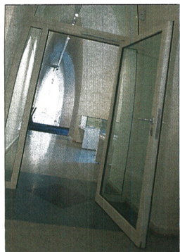
Neue Sicherheitstüren sollen Feuerchäden mildern.
