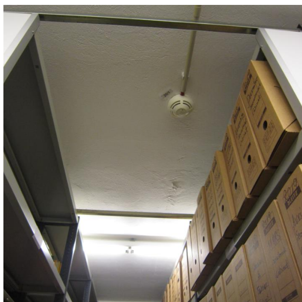
(8) Détecteur incendie. © ANLux
