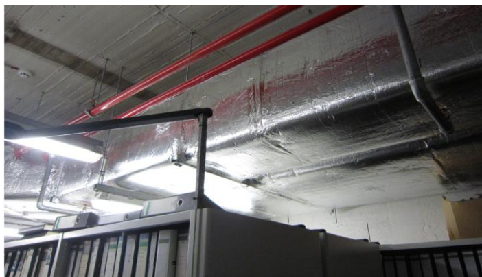
(3 et 4) Présence de conduites isolées à proximité des archives © ANLux
